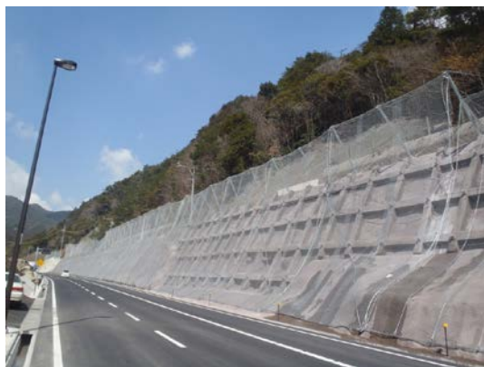
写真-1 ネットワン施工例
