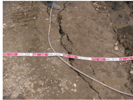
写真-3 沈下状況 (2)
