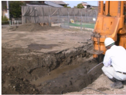
写真-2 沈下状況 (1)
