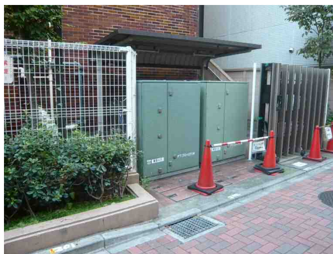
図 3-9 公共用地等への地上機器設置事例
