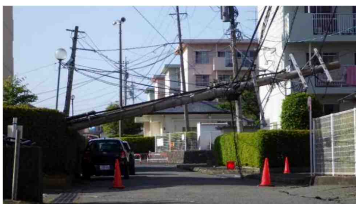
図 1-2 熊本地震による電柱の倒壊
