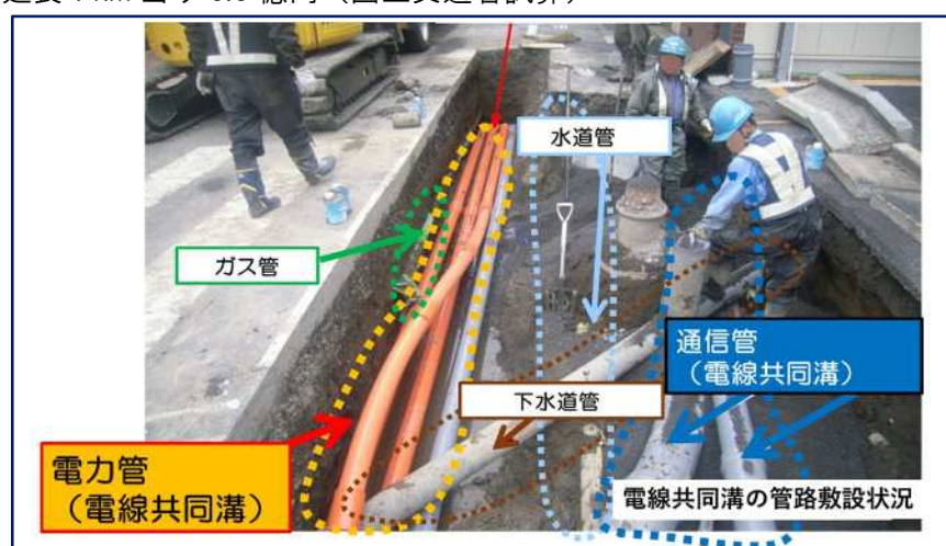
図 II -1 輻輳する地下埋設物
